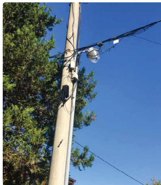
Использование усиленных привариваемых коннекторов устраняет беспорядок на столбах и привисание кабеля.
